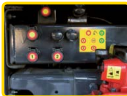
2C009651 + 2C003205 Kran og LS styrt hydraulikk
