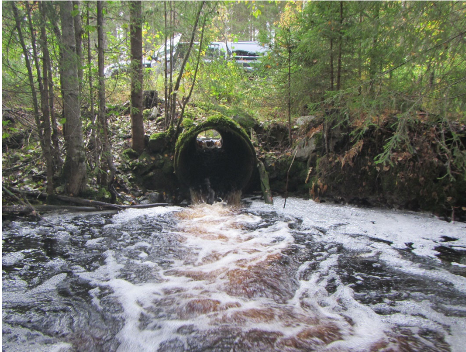
Figur 28. Kulvert I Kvernbekken, vandringshinder. Et naturlig vandringshinder er rett i overkant av kulverten.
