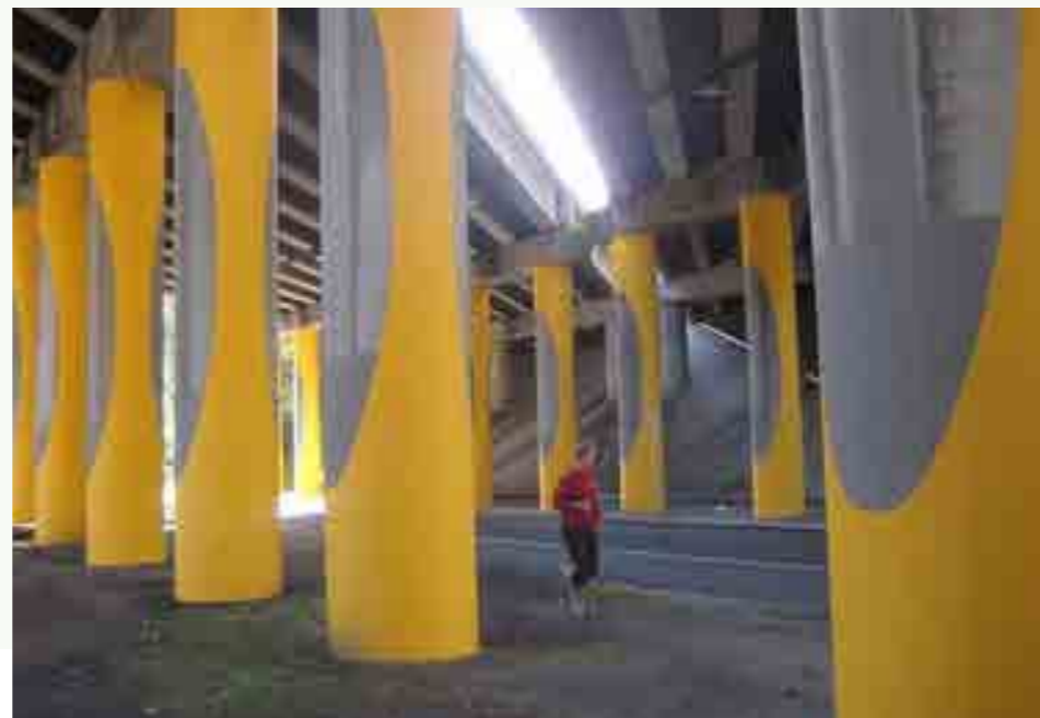
En bro har fått nytt uttrykk med enkle midler I-5 underpass, Seattle / Sheila Klein
