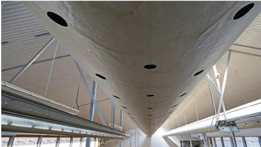
Figur 3 Nærbilde av en tube til tubeventilasjon i en kalveavdeling. Man kan se de små hullene det kommer frisk luft ut av. Bilde hentet fra:
