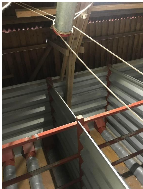
Figur 11: Viser eksisterende korn tørke, med luftkanal i bunn og tilførselsrør over kornbinge. Foto: Lars Jakob Veflingstad, 2022.
