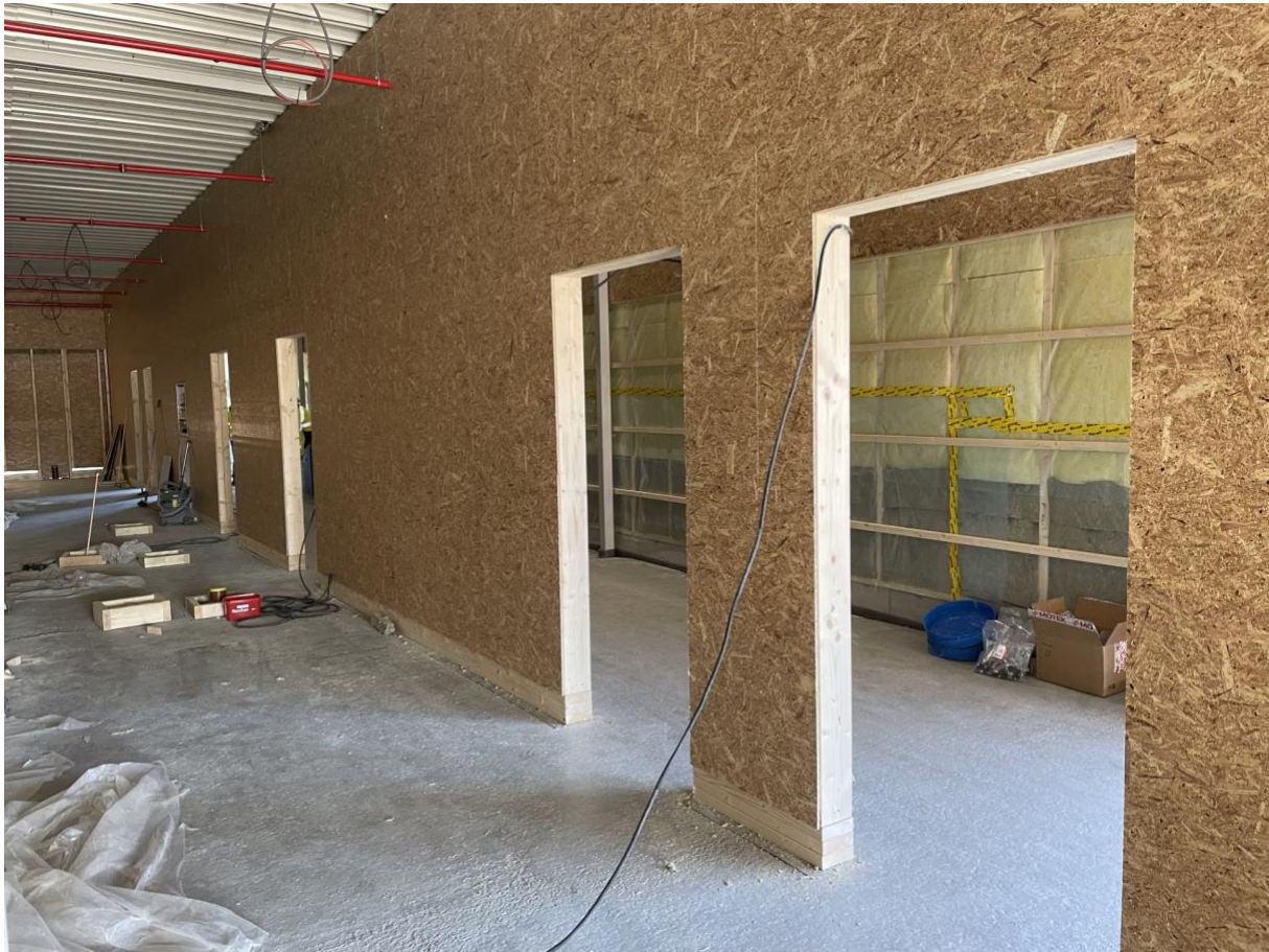
Figur 9: Bilde av plasseringen av hvor de ombrukte dørene skal plasseres (bilde tatt under omvisning på byggeplassen).
